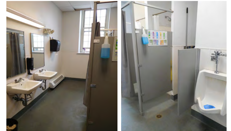
Non compliant Restroom
